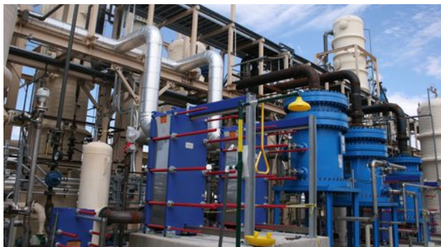
Figura 12 – Sistemas de Concentração - usina Kay Bailey Hutchingson em El Paso - Texas
