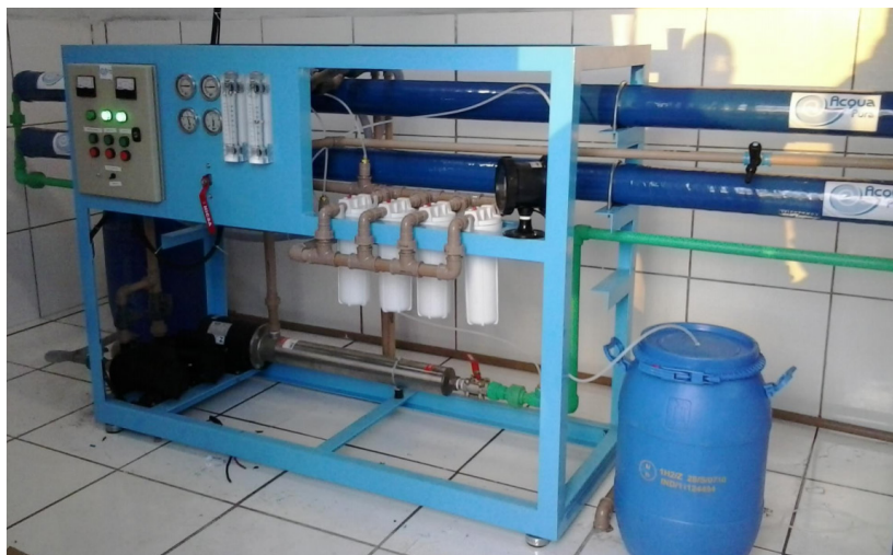
Figura 8 – Equipamento de osmose reversa
