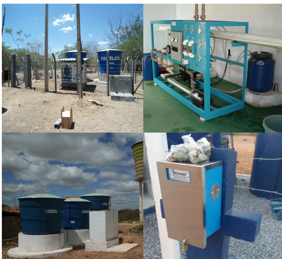
Figura 29 – Sistemas implantados pela SIRH - em sentido horário: dessalinizador cabinado, dessalinizador em abrigo de alvenaria, ficheiro de distribuição de água dessalinizada, reservatórios
