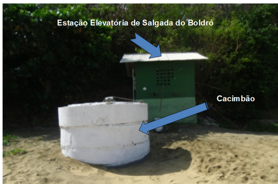
Figura 44 – Poço de sucção e unidade elevatória
