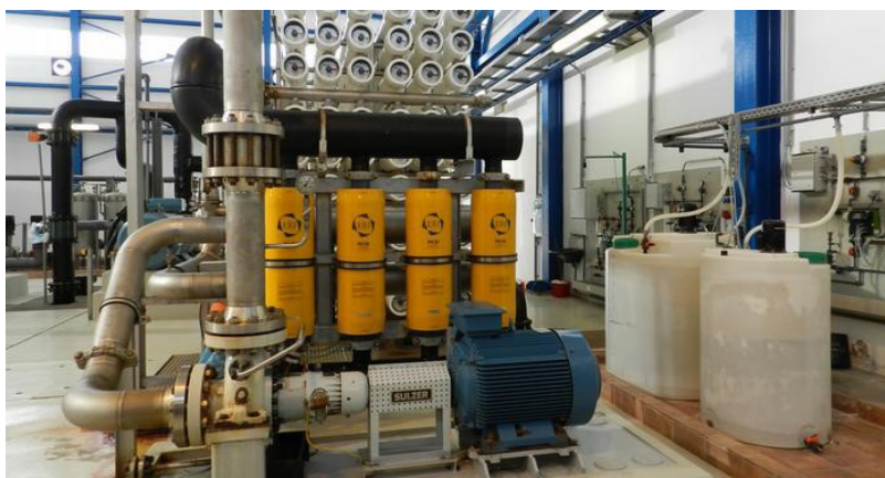
Figura 19 – Tubulações e estrutura da planta de dessalinização na Ilha do Sal em Cabo Verde
