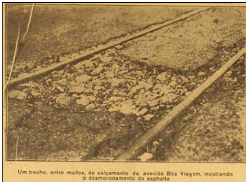
Figura 6: Calçamento desgastado da avenida Beira Mar
