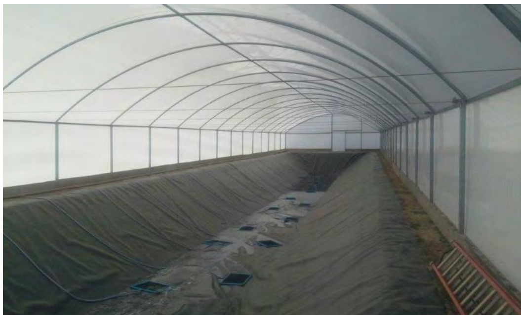
Figura 3. Estrutura de viveiro em montagem para cultivo em BFT. Fonte: Wesley Dantas dos Santos.
